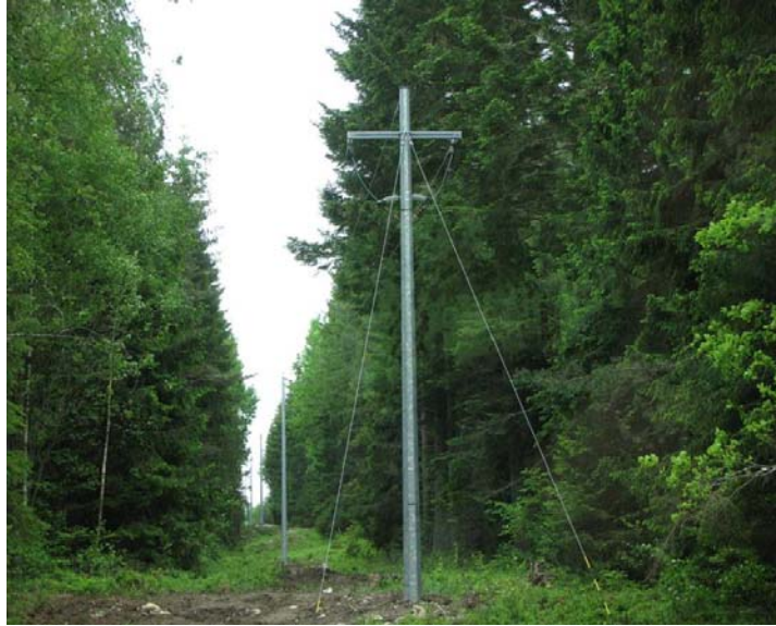
Kuva 3. Vattenfallin teräspylväinen BLL-johto Ruotsissa.
