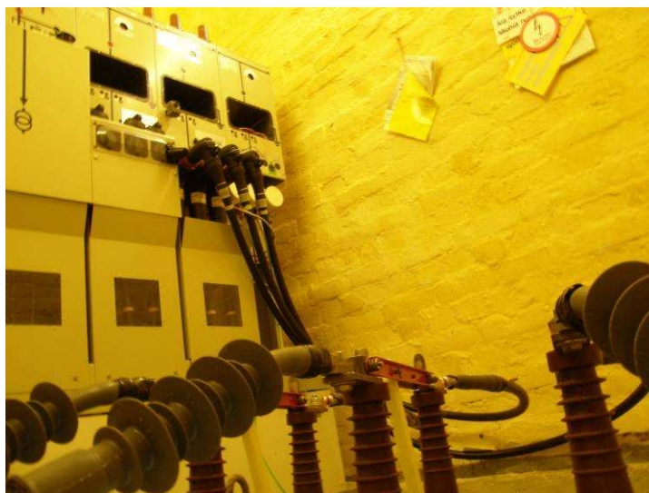
Kuva 44. Koevaunun kaapeleiden liitöntäköhta kojeistossa.
