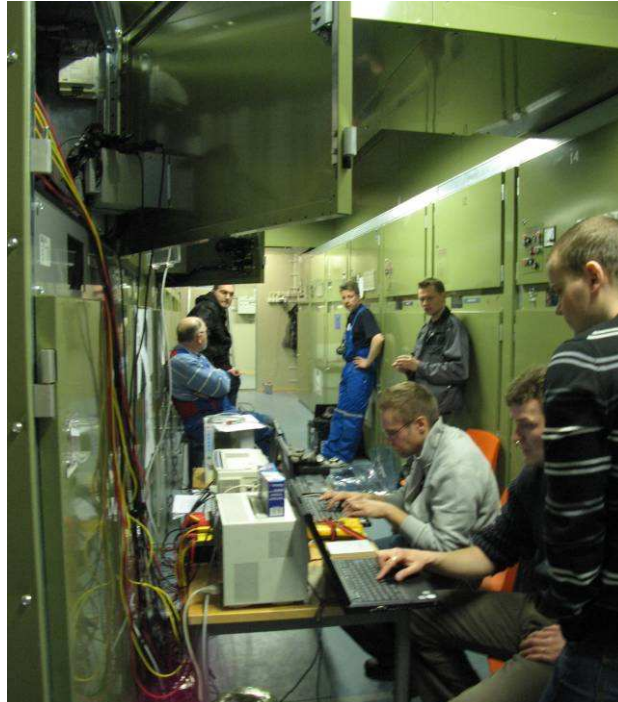
Kuva 46. Näkymä sähköaseman mittaustilanteesta..
